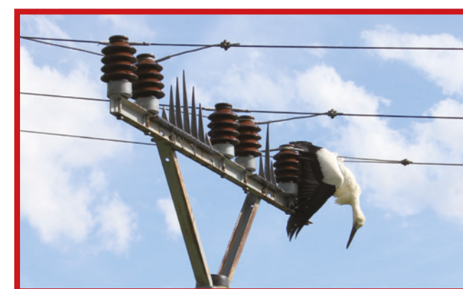
(20) Smutný koniec zosadenia bociana na nezabezpečený stĺp elektrického vedenia
