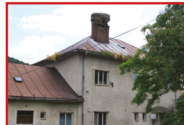
(46) Trusom znečistená strecha a hniezdnym materiálom zanesené žľaby
